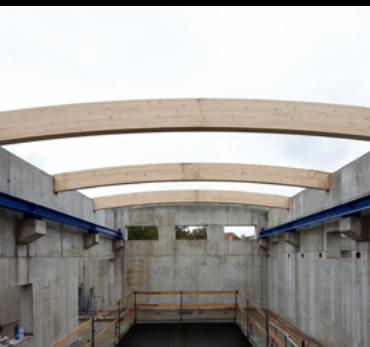
Malá vodní elektrárna, Beroun
