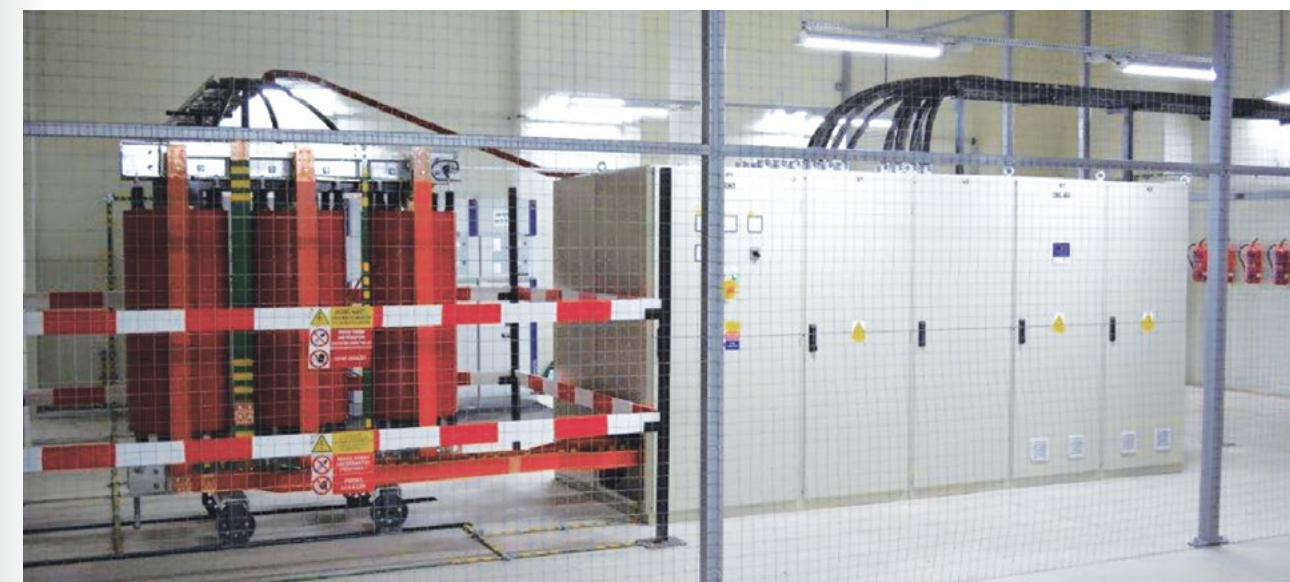
Nová trafostanice a rozvodna vysokého napětí – uvedení do provozu květen 2015
