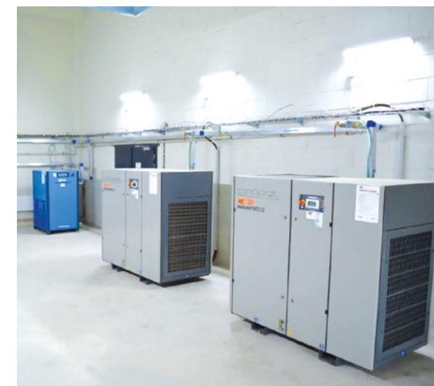
Nová kompresorovna – uvedení do provozu duben 2015
